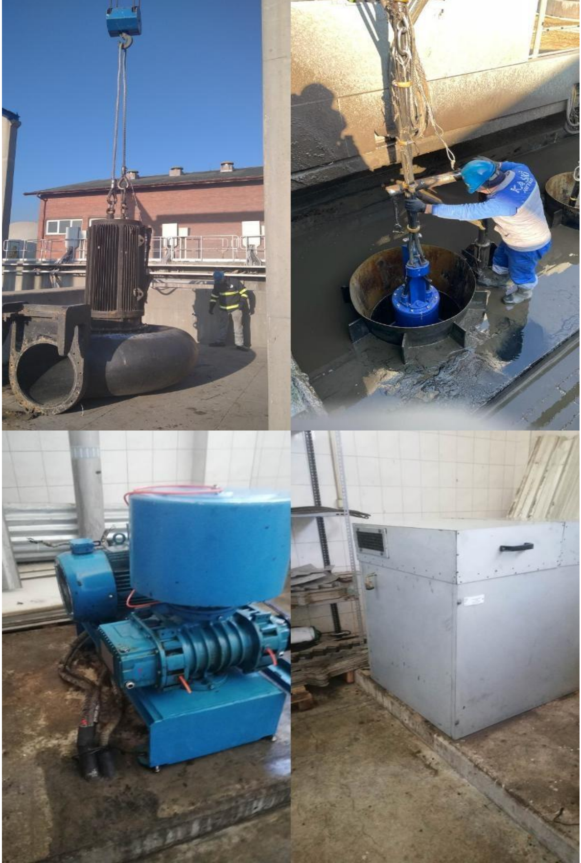
Pompa ve Blower Bakımları
