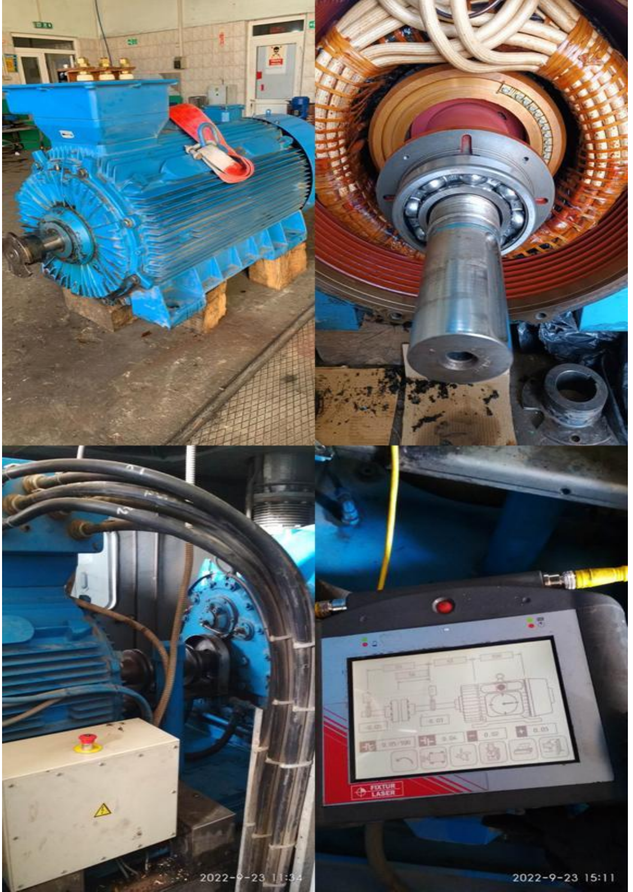
T. Blower Motor Bakımı ve Kalplin Ayarı
